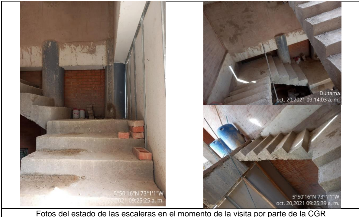
Fotos del estado de las escaleras en el momento de la visita por parte de la CGR
