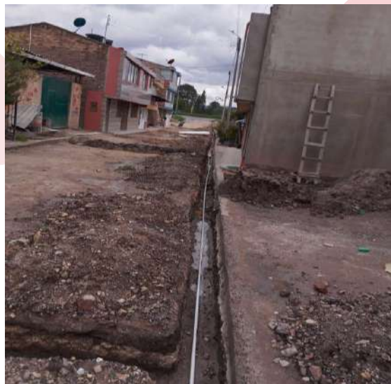
Ilustración 48. Agua potable saneamiento básico rural tubería de acueducto de diferentes diámetros
